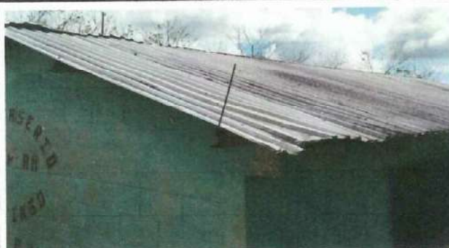
Foto 2: Techo deteriorado y aula 1, 2 y Direccion.
